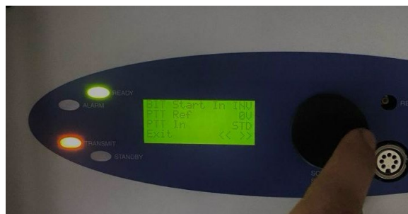
Figure 6. 0 volt voltage PTT Ref display
